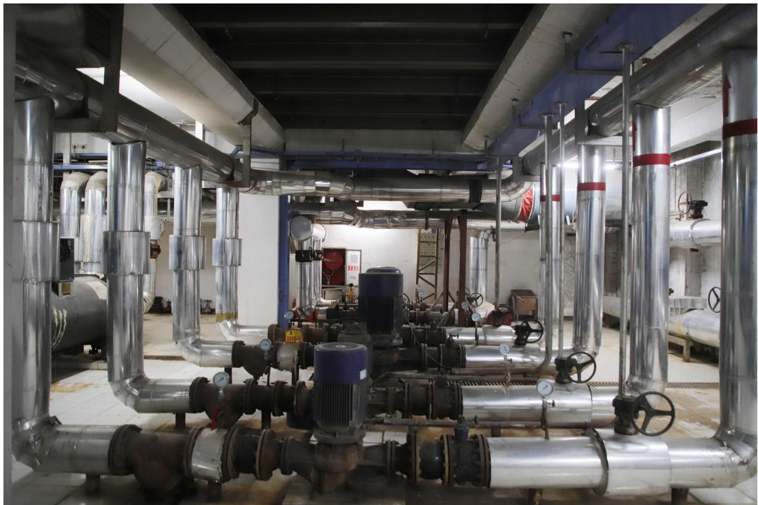
新闻大厦空调系统一次网安全运行
