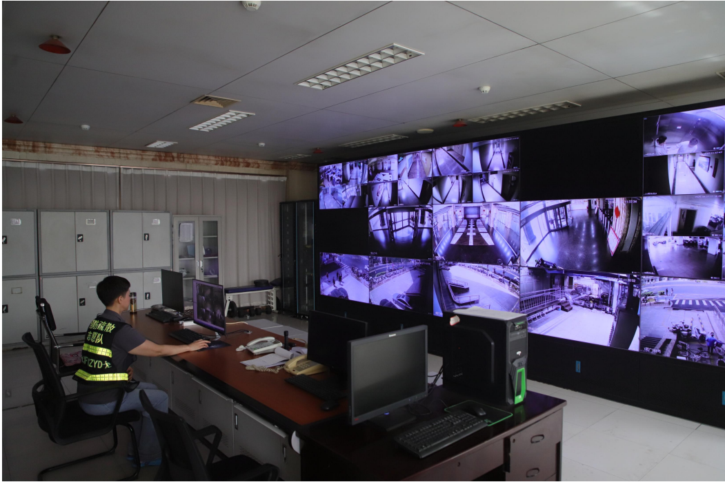
新闻大厦中央监控室
