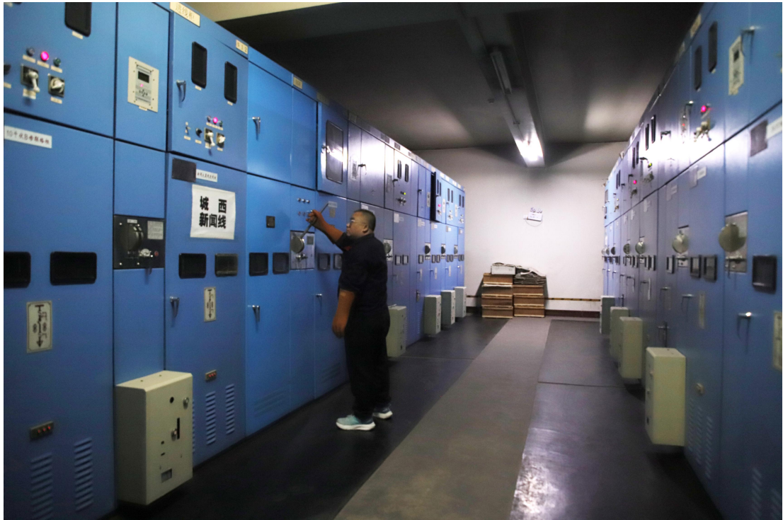
新闻大厦配电室安全检查
